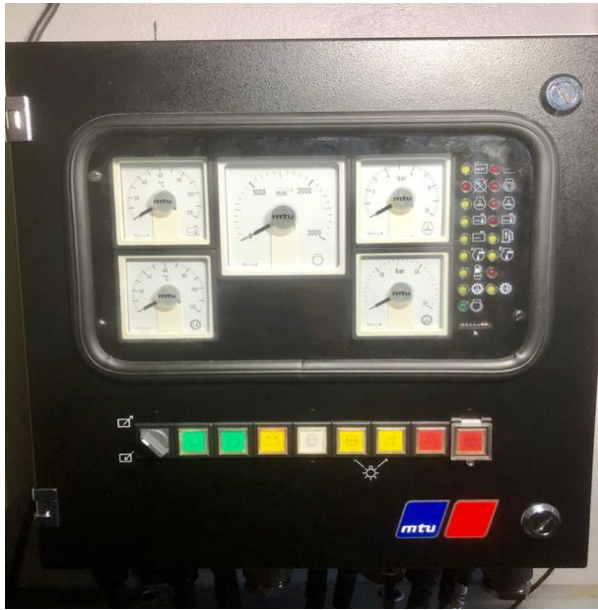
Figur 8. Local Operating Panel, utvendig før utvidelsene.
