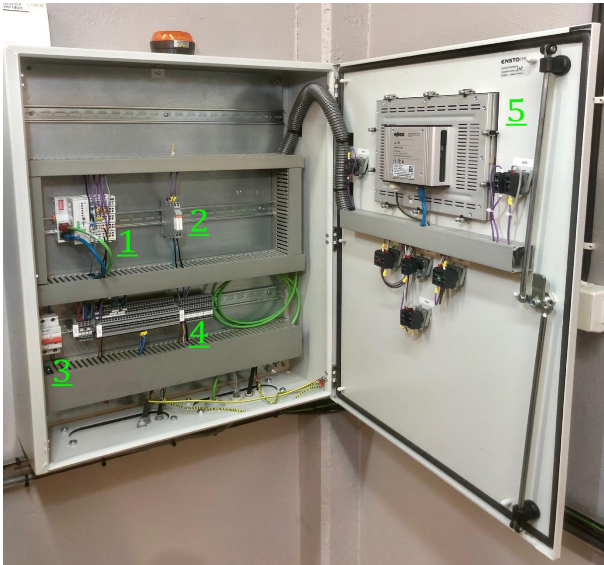
Figur 22. RCS innvendig. 1.WAGO PLS. 2.Reléer. 3.Sikring (F1). 4.Rekkeklemmer (X0, X1 og X2). 5.WAGO webpanel.
