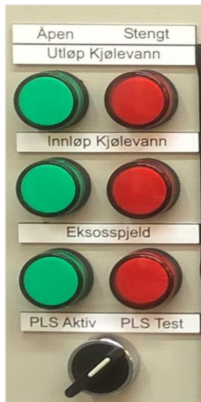
Figur 23. Indikasjonslamper i fronten av Main Control
