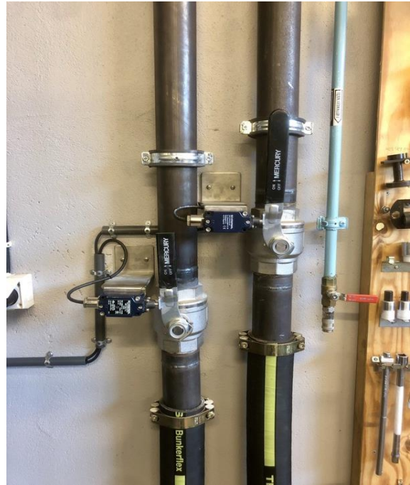
Figur 25. Endebrytere kjølevannsventiler, åpen stilling.
