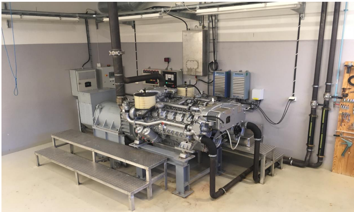
Figur 6. Oversiktsbilde av MTU dieselgenerator ved KNM T / SSS.
