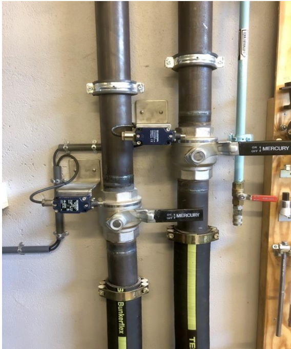
Figur 24. Endebrytere kjølevannsventiler, stengt stilling.
