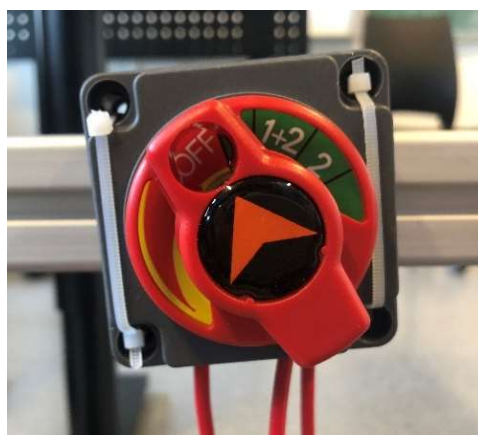
Figur 2.27: Hovedstrømsbryter, med stillinger: OFF, 1, 1+2 og 2. Den velger om batteri 1, batteri 2 eller begge skal være tilkoblet hovedfordelingen.
