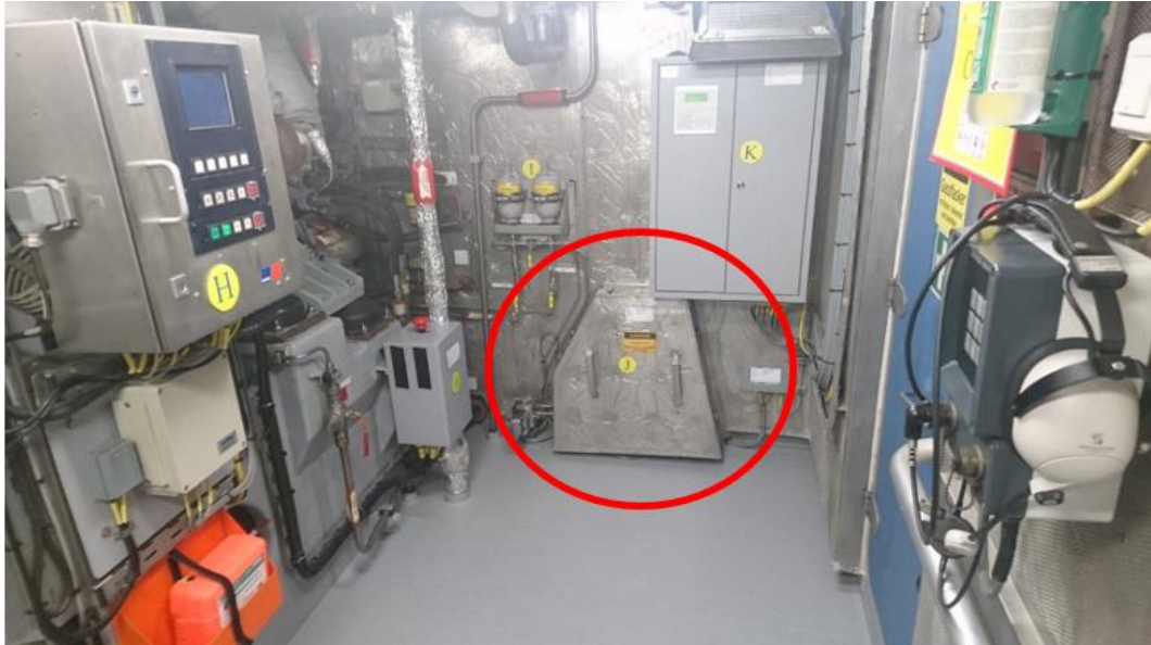
Figur 8. Bilde av forre maskinrom på BB side
