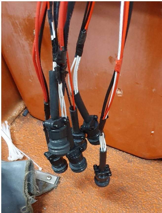
Figur 3.5: Hurtigkoblinger mellom ledningsnettverket og styringsmodul. Kablene fører til aktuatorene og det originale ledningsnettverket
