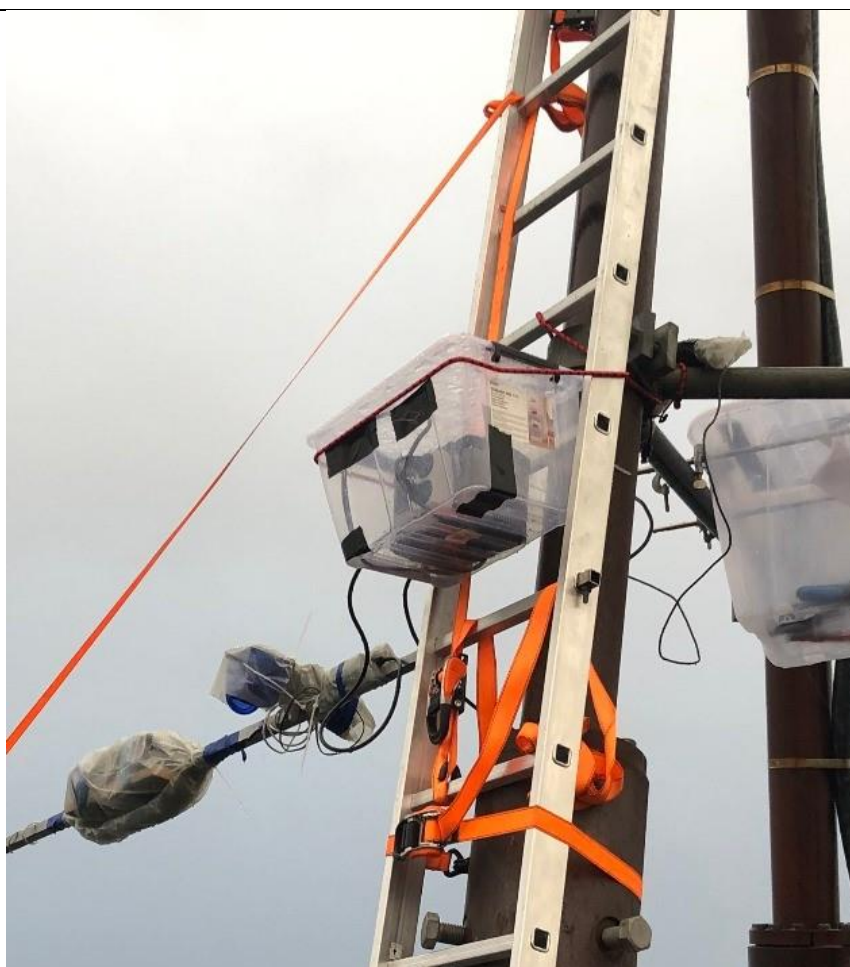
Figur 23: Strømstasjon montert på riggen under måling
