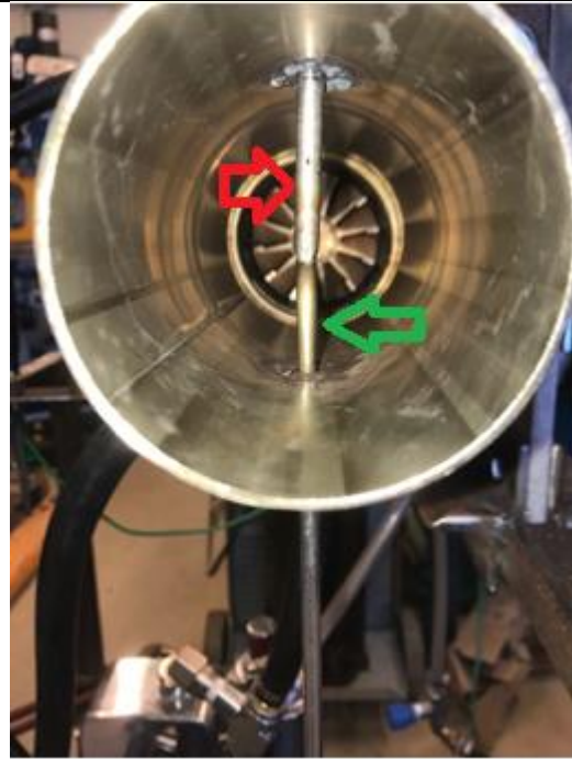
Figur 3.20 Måleinnretninger montert etter turbin T04
