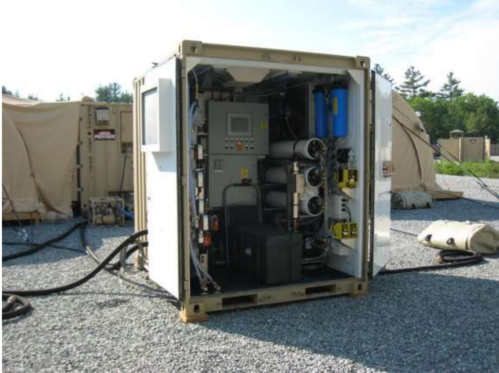
Figur 23: SWRS- rensecontainer (Good, 2011). Bildet viser renseanlegget, som er en del av trippelcontaineren.
