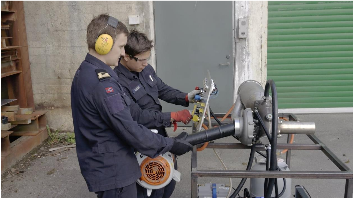
Figur 4.1: Kadett Panfilovs og Finden under oppstart av gassturbin for første gang
