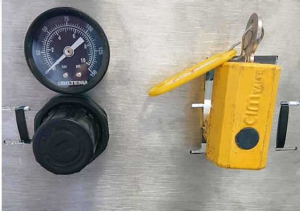
Figur 3.13: Trykkregulator med manomanometer og stengeventil med lås
