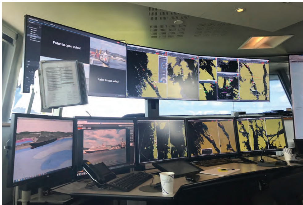
Figur 1: 3D kart tilgjengelig på Kvitsøy Sjøtrafikksentral vises på skjerm nede til venstre
