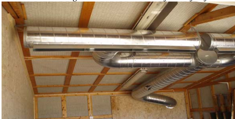
Figur 4: Et av 38 ventilasjonsanlegg som bygges for å redusere helseskader hos skyttere. Innholdet av Cu og Zn reduseres med en faktor fra fem til ti (Pedersen, 2011).
